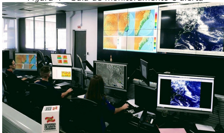
Figura 4 - Sala de monitoramento e alerta
