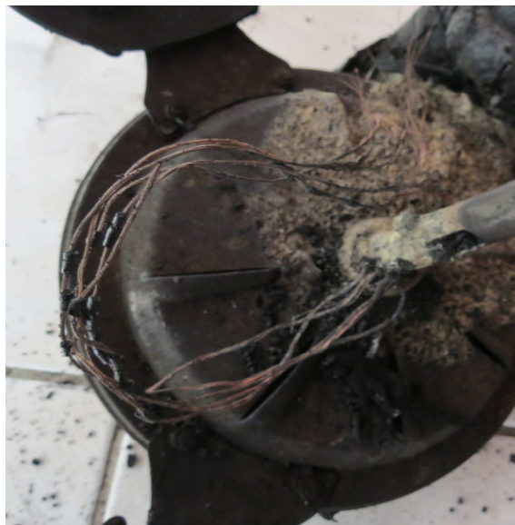
Figura 17 – Ventilador de teto definido como foco inicial do incêndio.
